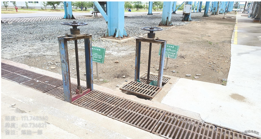
生产装置雨污分流装置
