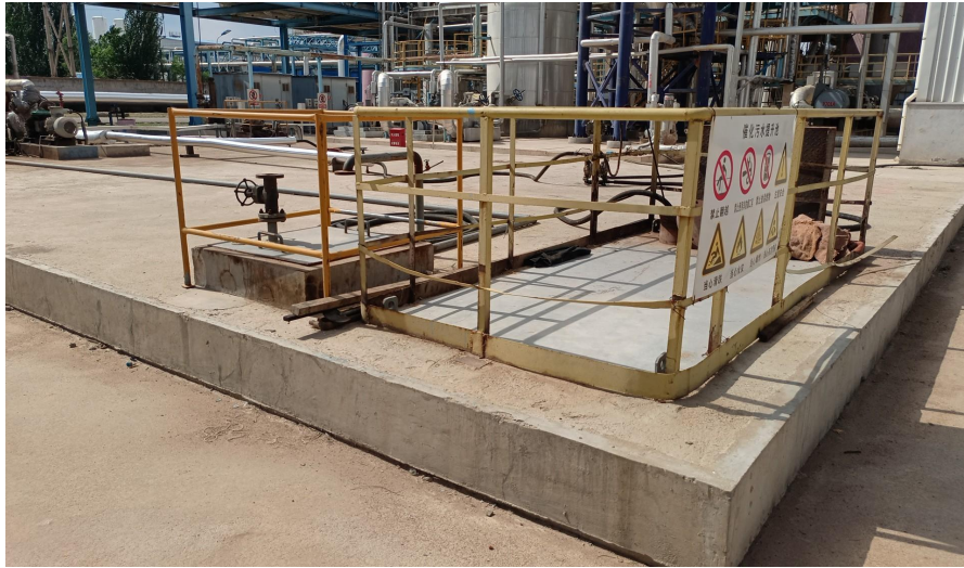
地下半地下池体
