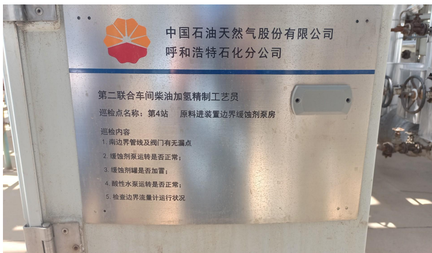
生产装置、传输泵巡检点
