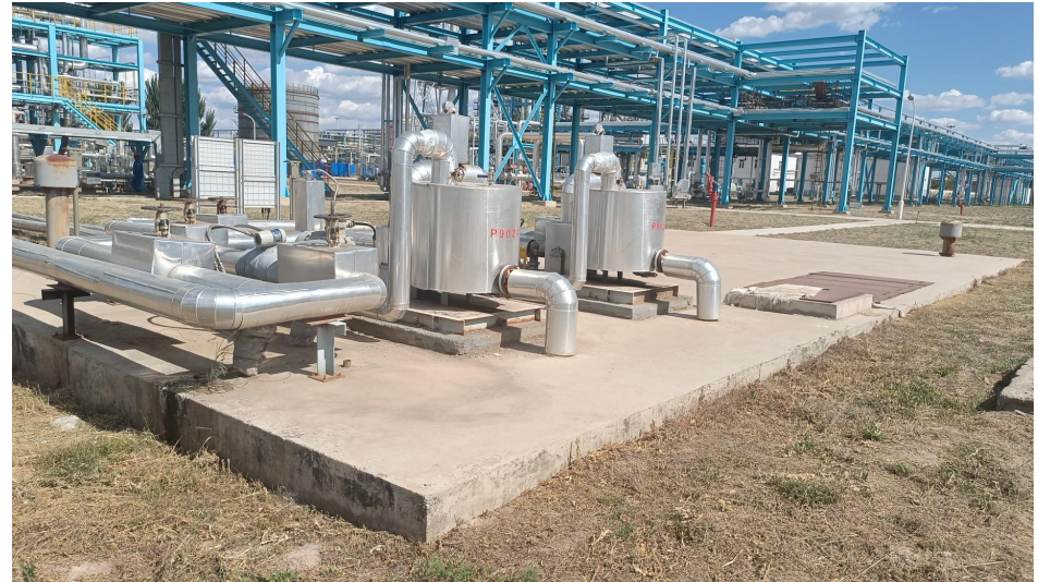
污水提升设施
