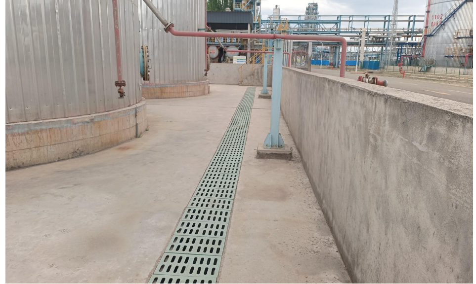
罐区内排水沟、围堤
