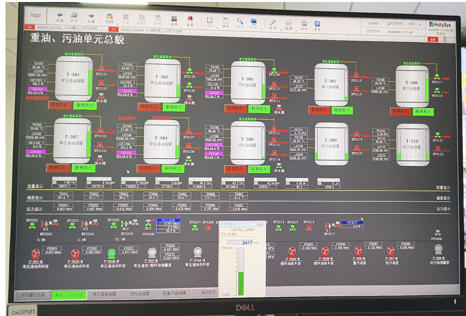
储罐液位计数据显示
